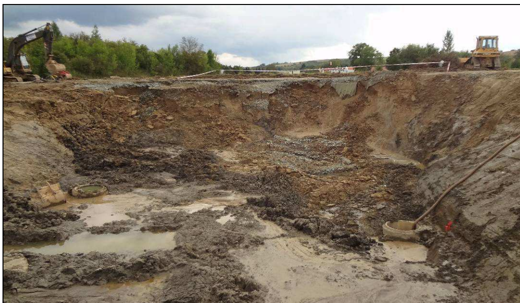
Výkop pro čističku se zaplavoval
